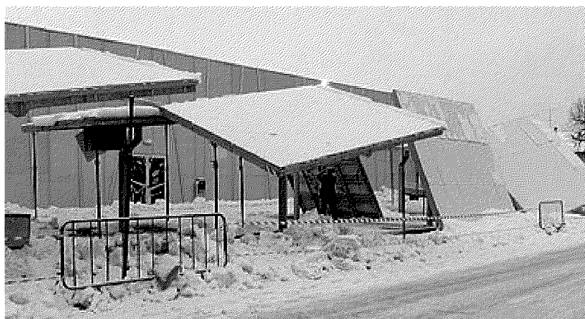
I pannelli collocati come copertura del parcheggio e che servivano per incamerare energia, crollati sotto il peso della neve
